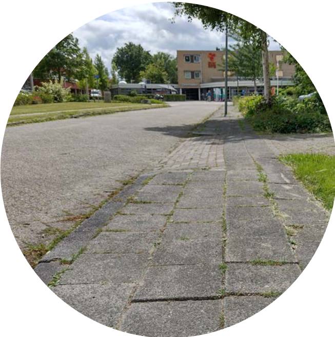
Trottoirs zijn aan een opknapbeurt toe!
