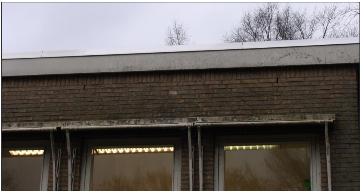
Figuur 12. Stootvoegen aan één van de blokken van de bedrijfsbebouwing. Aan alle zichtbare zijden van dit blok waren stootvoegen aanwezig.
