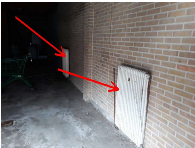
Foto 5: 2 ledenradiatoren in de garage
