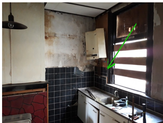
Foto 2: Situering MM10, vlakke plaat achter geiser
