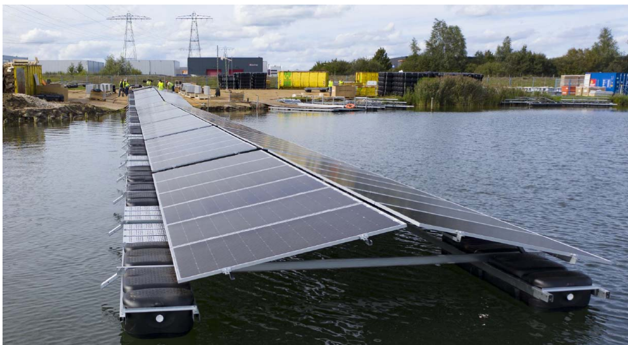
Figuur 2.6: Foto van een te realiseren zonneponton met oost-westopstelling
