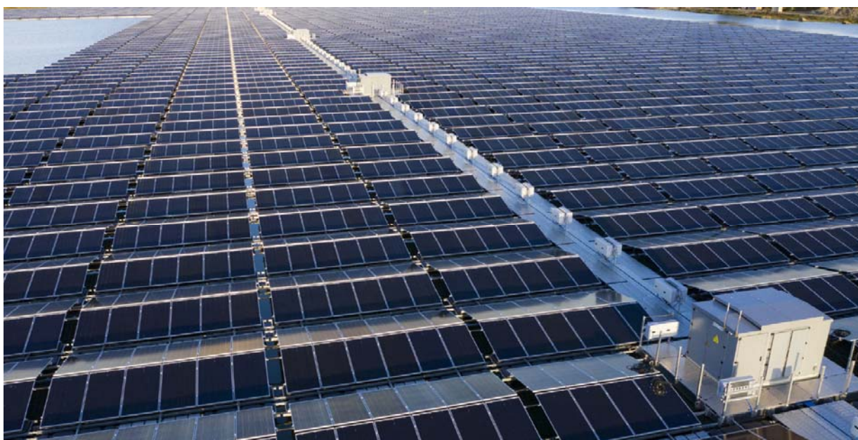
Figuur 2.7: Foto van een 'omvormerstraat' en transformatoren
