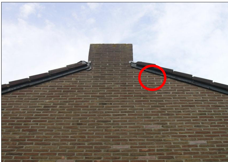
Figuur 6. Verblijfplaats nr. 13 tussen stenen en daklijst
