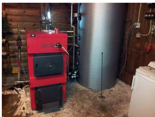
Opstelling van een biomassa-installatie in de vorm van een hout(pallet) CV
