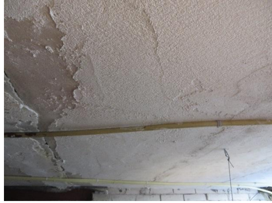
In het verleden uitgevoerde herstelmaatregelen
