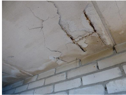
Geconstateerde schade bij de oplegging
