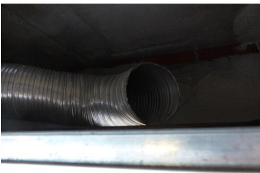
Geconstateerde gebreken toiletruimten
