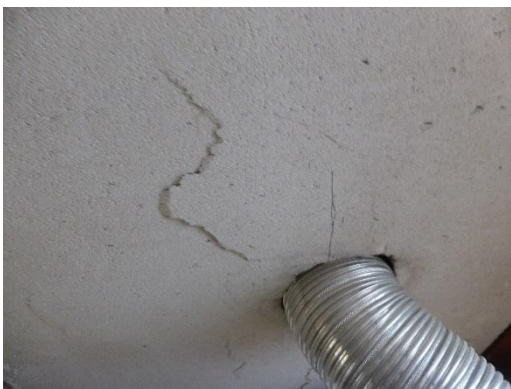
Geconstateerde gebreken toiletruimten
