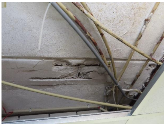
Blootliggende wapening / betonrot
