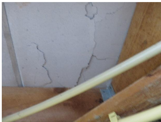
Scheuren in de gasbetondakplaten.
