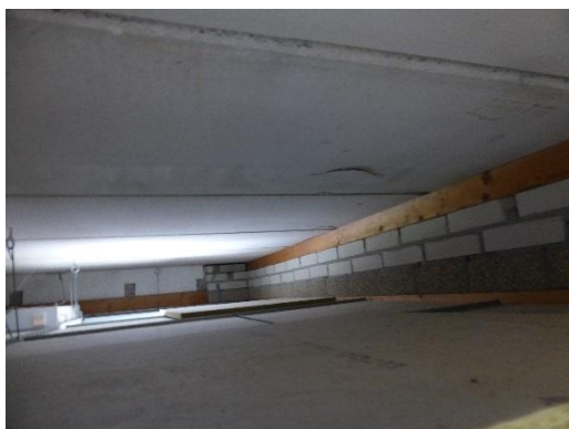
Geconstateerde gebreken kantoren
