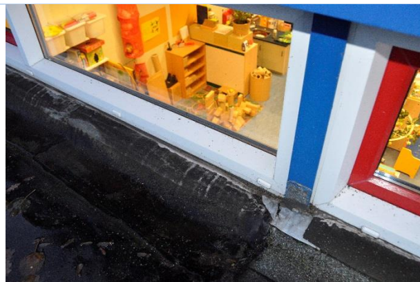
Gebrekkige loodslabben onder kozijnen boven daken, risico vochtdoorslag/ lekkage
