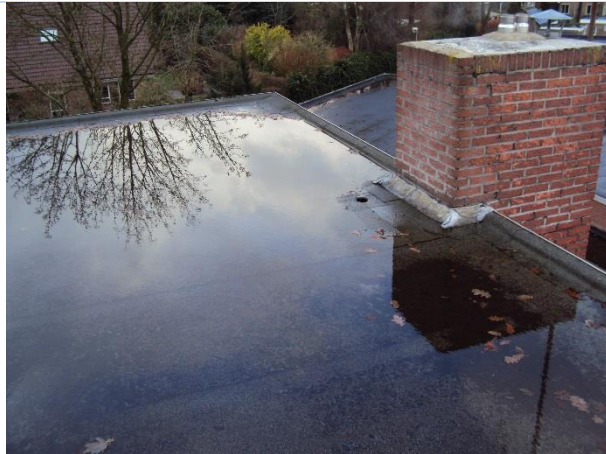
Onvoldoende afschot en te hoog geplaatste afvoeren, daardoor verspreidt grote hoeveelheden water op daken
