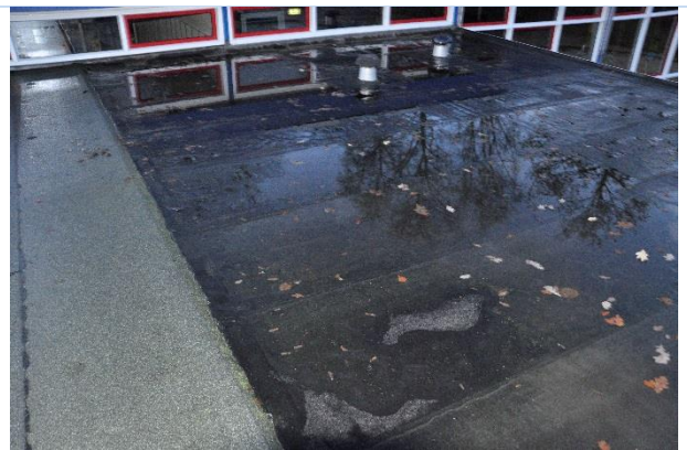
Onvoldoende afschot en ontbreken noodoverstorten (constructief gebrek)
