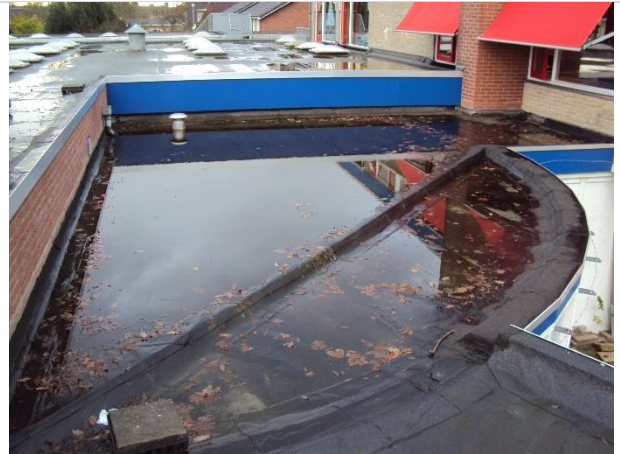
Ontbreken noodoverstorten (constructief gebrek)
